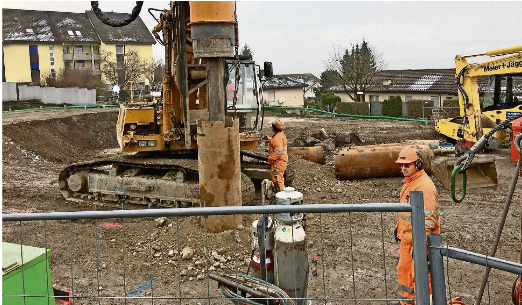
Auf dem Areal des ehemaligen «Kellerämterhofs» in Oberlunkhofen wird der Baugrubenabschluss erstellt, wofür 78 Bohrungen notwendig sind.
